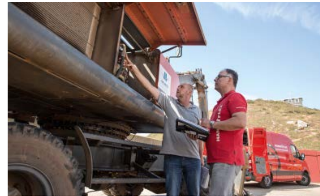
» Da für den großen Atlas-Bagger keine ausreichend dimensionierte Halle zur Verfügung stand, erfolgte die Montage im Freien. » As there was no sufficiently large hall available for the large Atlas excavator, the assembly work took place outdoors.
