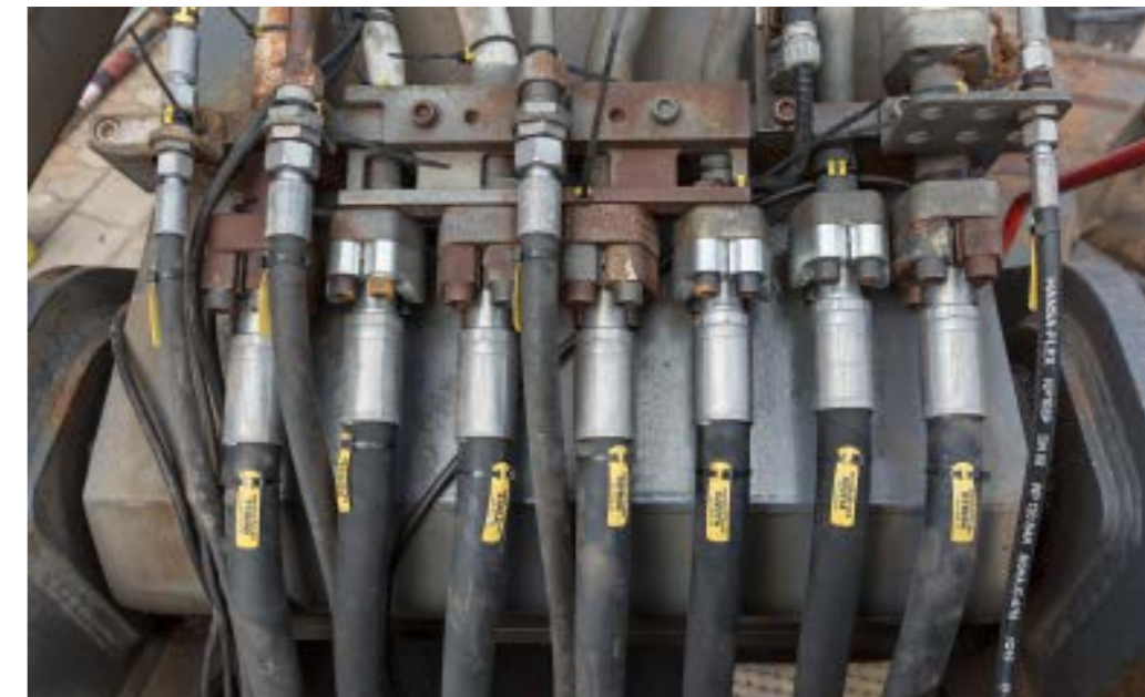
» Im Hafen sind die Hydraulikschlauchleitungen und Verschraubungen einer enormen Beanspruchung durch Salzwasser, Seeluft und Sand ausgesetzt.
