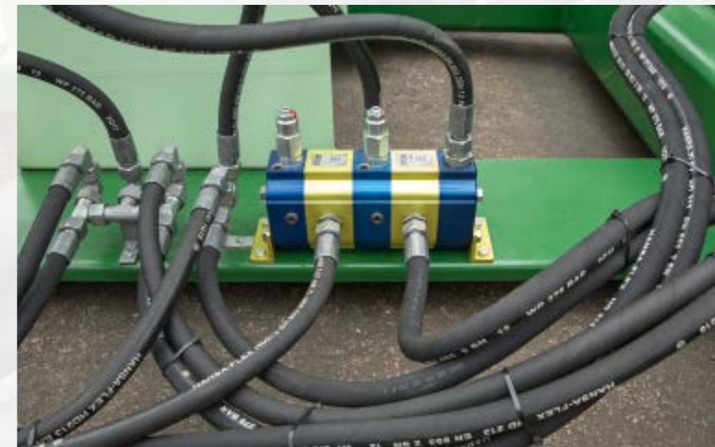
» Kernelement jeder Anlage ist die Hydraulik.
