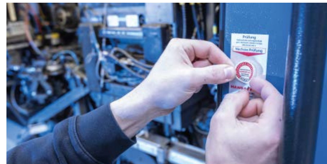
Nach den erfolgreich ausgeführten Wartungsarbeiten wird der nächste Zeitraum für die vorbeugende Instandhaltung festgelegt und mit einer Plakette direkt an der Maschine dokumentiert. Damit werden ungeplante Ausfallzeiten vermieden.
